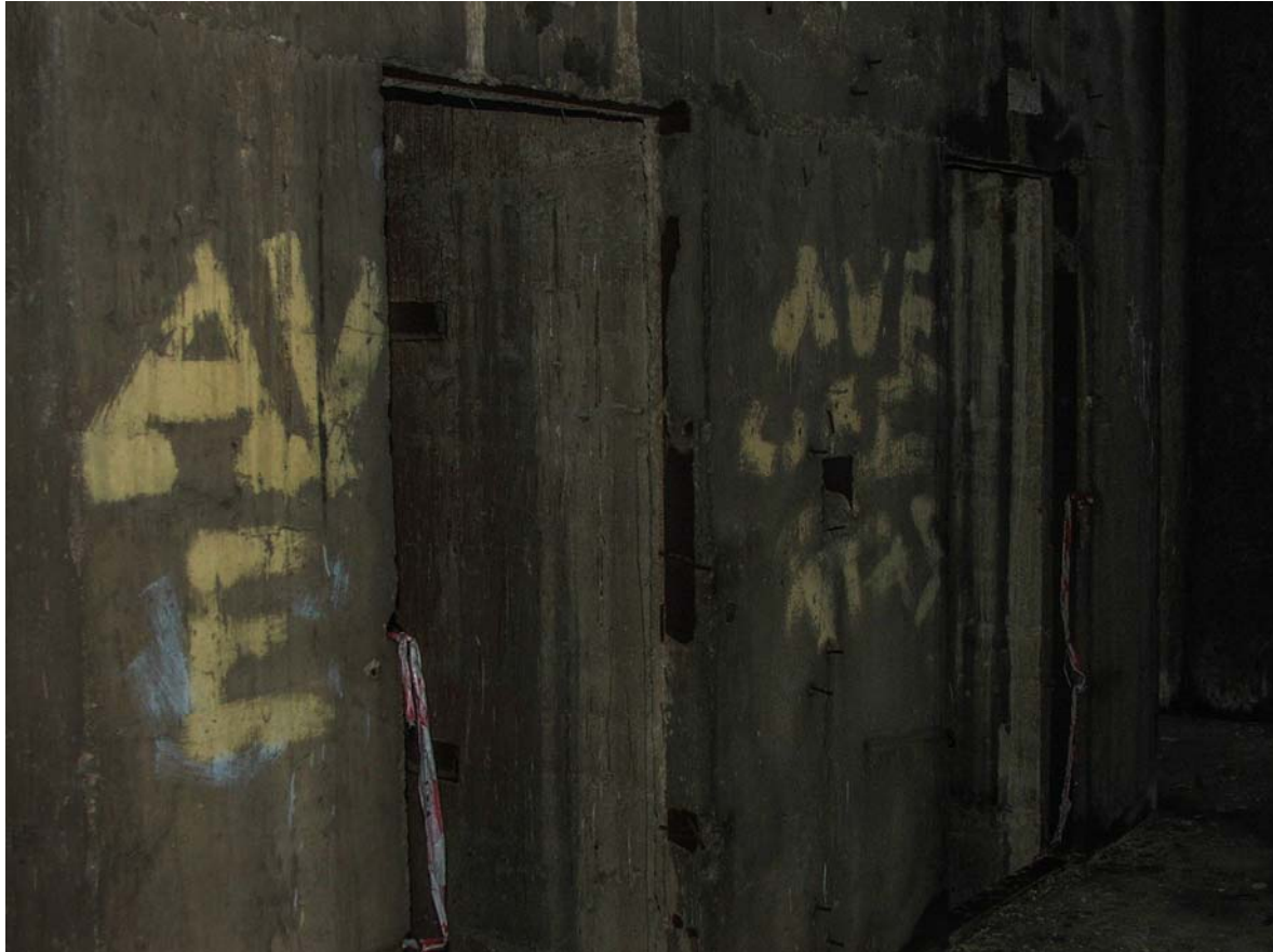
Niezabezpieczony szyb windowy (fot. Damian Dziura)
